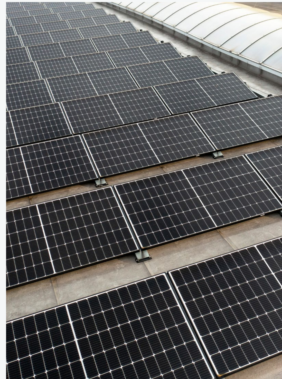
➤ Panele fotowoltaiczne na budynku FAMUR S.A. Mining Oddział w Katowicach
